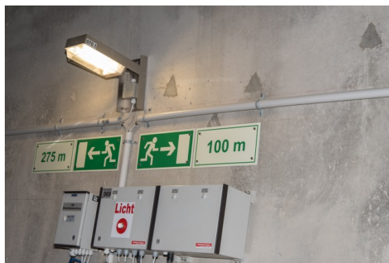
Abbildung 50: Fluchtwegkennzeichnung unter Notbeleuchtung
