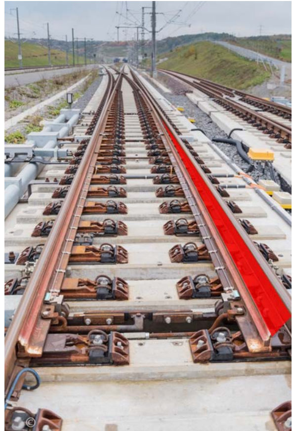
Abbildung 2: An Weichen besteht auch Quetschgefahr
