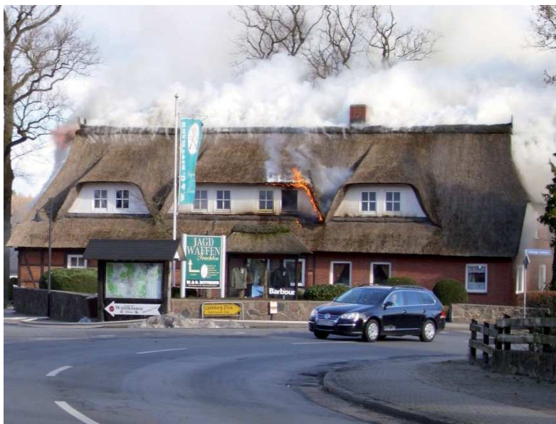
Abbildung 24 - Brand breitet sich durch offenes Fenster in Hinterlüftungsebene und auf dem Reet aus. Aufgrund großflächiger Rauchentwicklung im First ist nicht mehr mit einem Löscherfolg zu rechnen!
