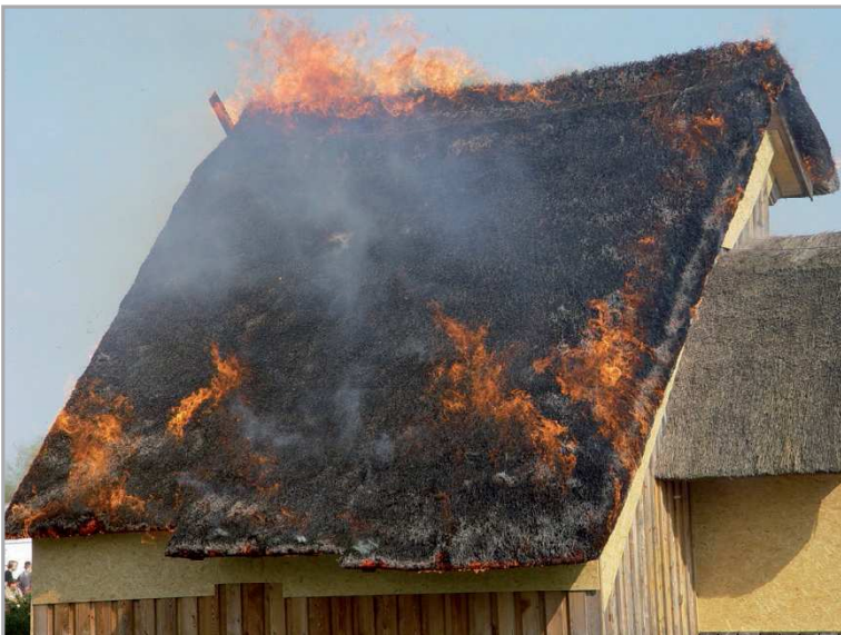
Abbildung 13 - Glimmbrandphase mit Flammeneerscheinungen vorwiegend an den Rändern/First
