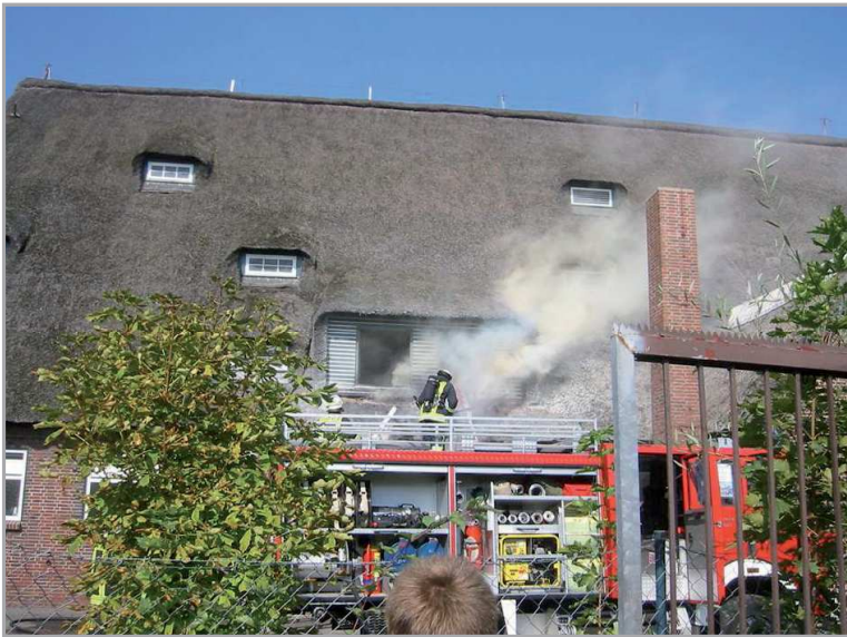
Abbildung 20 - Trotz Löschmaßnahmen breitet sich das Feuer weiter aus (vermehrte Rauchentwicklung), da keine Öffnung der Eindeckung um den Brandherd stattfand
