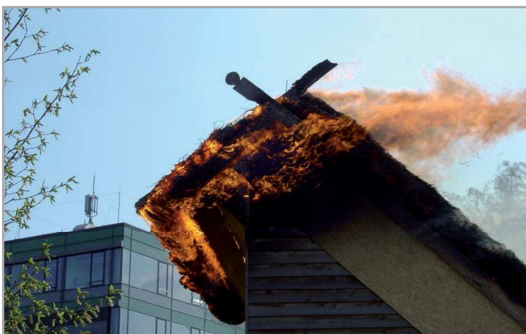
Abbildung 16 - Feuer breitet sich unterhalb der Traufe in der Hinterlüftung aus (Lösch Erfolg nicht mehr gegeben!)
