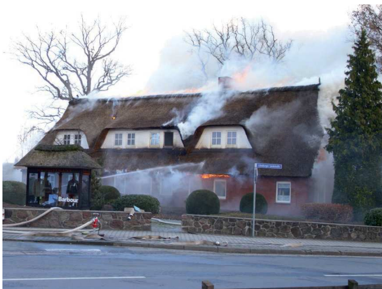
Abbildung 25 - Feuer dringt bereits aus Öffnungen in der Eindeckung und unterhalb der Traufe aus
